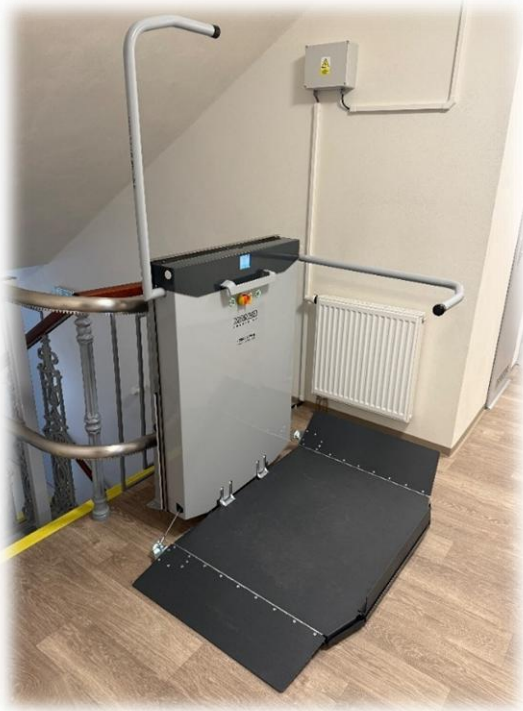
Schodišťová plošina na Denním Stacionáři
